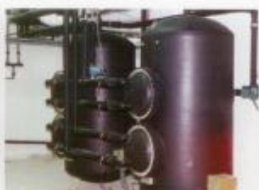
Μόνωση δεξαμενών και σωλήνων με ARMAFLEX
