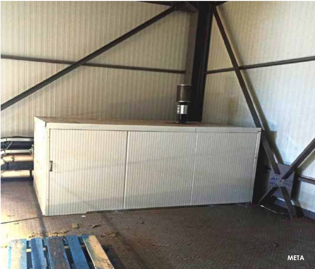
Ηχομόνωση αντλίας κενού σε βιομηχανία
