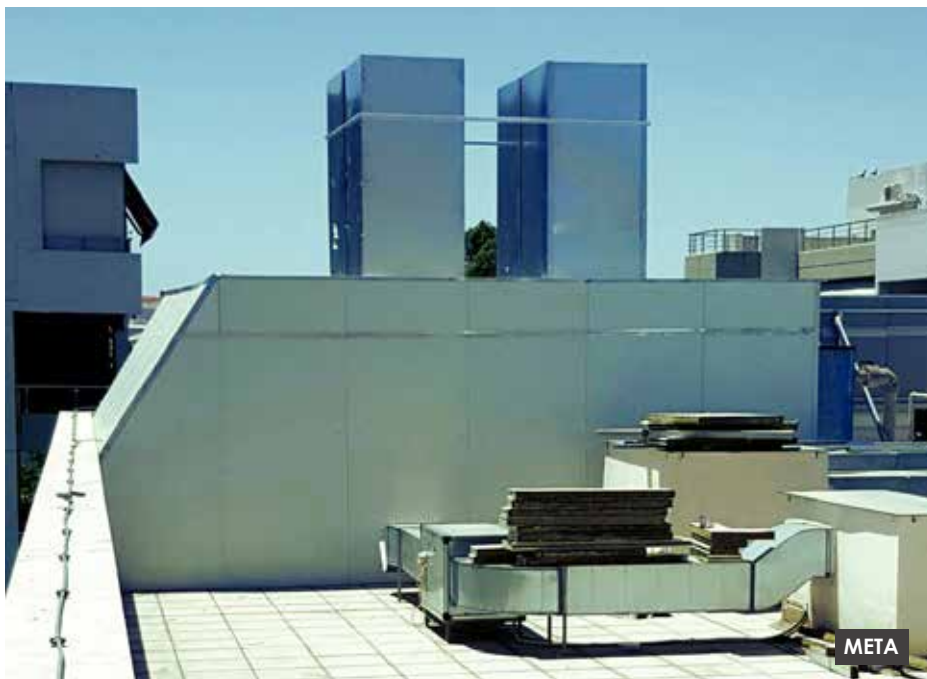
Ηχομόνωση κλιματιστικής εγκατάστασης Νοσοκομείου
