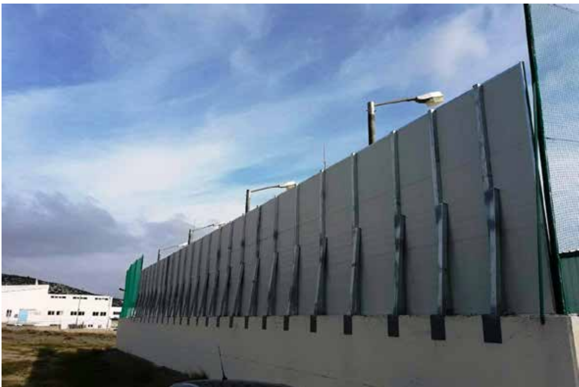
Ηχοπέτασμα Εγκατάστασης Φυσικού αερίου
