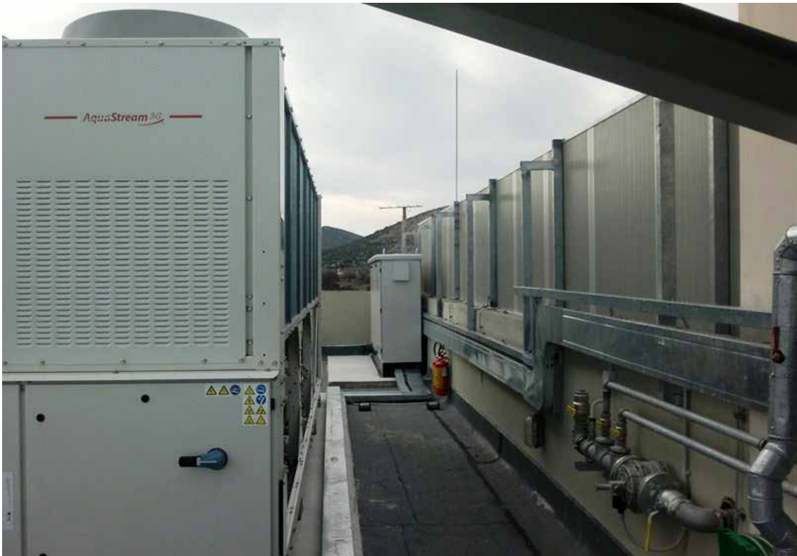
Ηχοπέτασμα σε ψύκτες κλιματισμού
