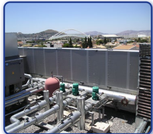
ΕΦΑΡΜΟΓΗ ΣΕ ΗΧΟΜΟΝΩΣΗ ΜΗΧΑΝΟΛΟΓΙΚΟΥ ΔΩΜΑΤΟΣ
